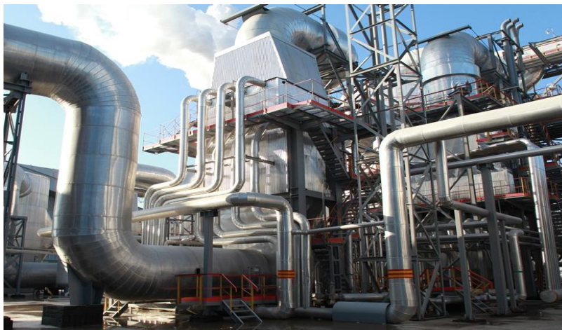
Сернокислотная система мощностью 1,1 млн. тонн H_2SO_4 в год
